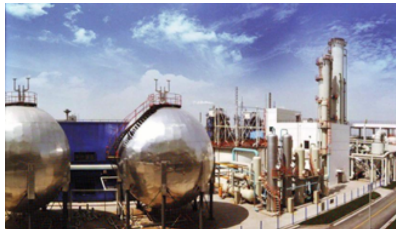
石洞口二电厂碳捕集装置
